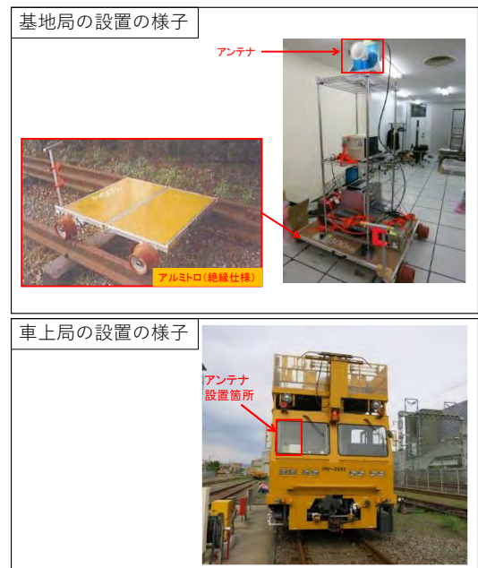
図 2 無線機の設置の様子
