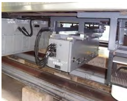
図 1 軌道変位モニタリング装置
