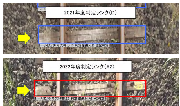
図 11 木まくらぎの劣化度の進行
