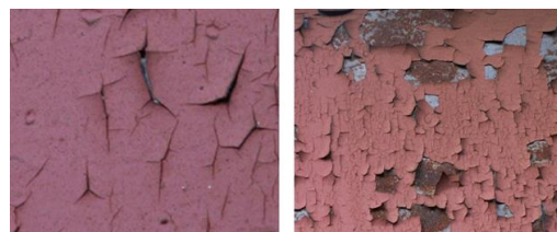
割れの事例 割れ、剥がれの事例
