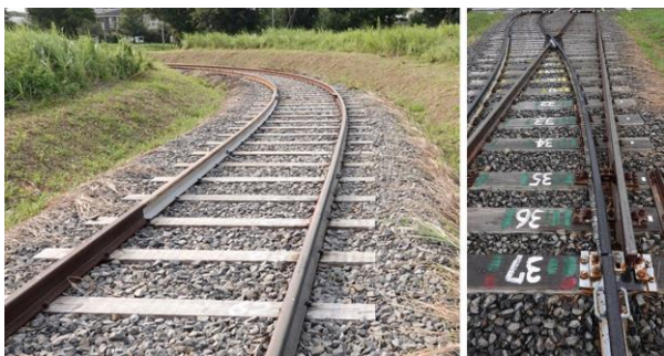
図4 緩和曲線における高視認性機能性塗装と枕木ID等
