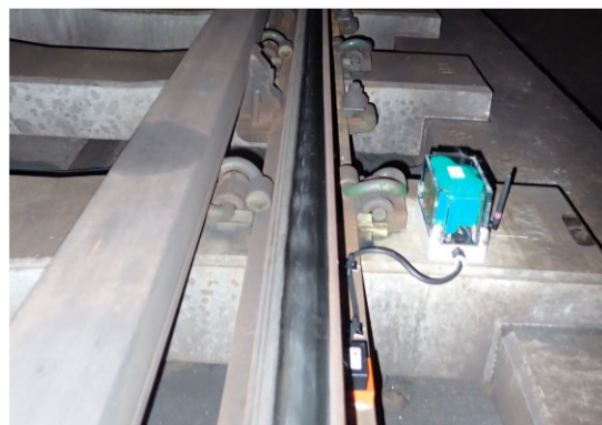
図 4 センサユニット設置箇所の内軌波状摩耗の発生状況
