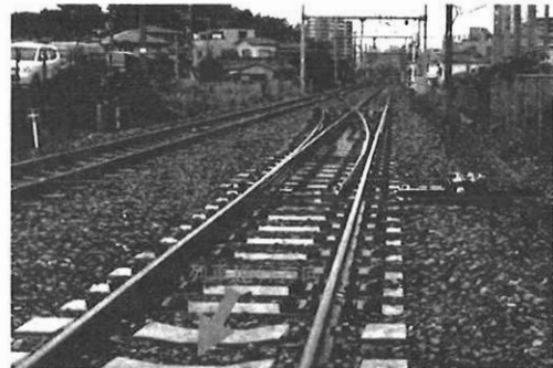
図5 試験敷設した弾性まくらぎ使用分岐器
