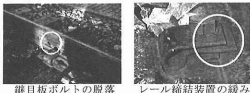
図1 軌道材料の異常状態の例
