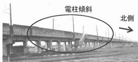
図-8 脱線箇所付近の架線電柱の傾斜 7)
