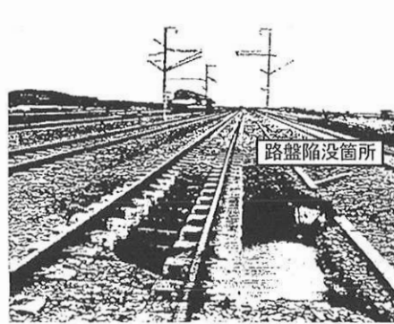
図-13 TGV 列車脱線位置の路盤陥没 13)
