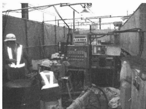
写真 1 現地プラント
