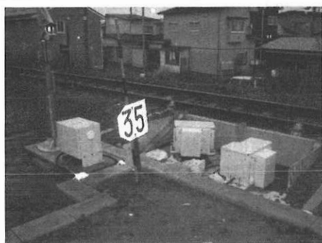
図 5 羽後牛島駅構内に設置した試験装置
