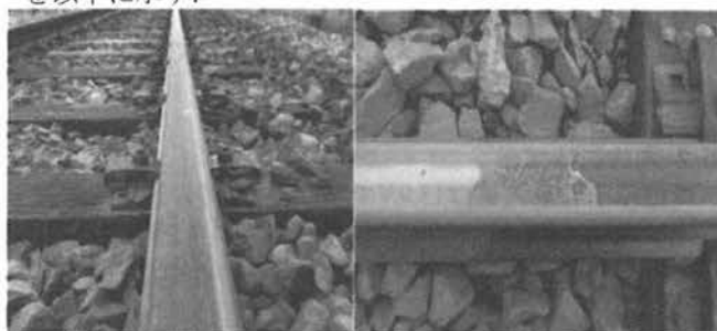
図.8 海水散布時のレール踏面状態
