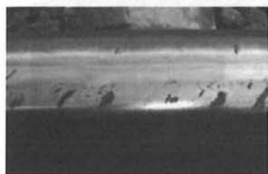
図 1 はく離を伴ったきしみ割れ
