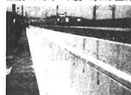
鉄筋コンクリート製バラスト止め
