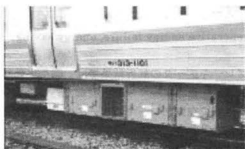
図3 EDLC (電力貯蔵装置)
