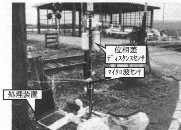
図8 誤進入検知システム
