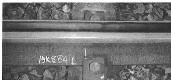
図-1：レール溶接部の外観（上から）
