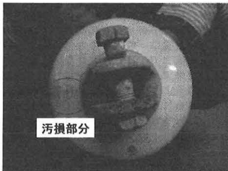
図2. 実設したがいし表面の汚損状況
