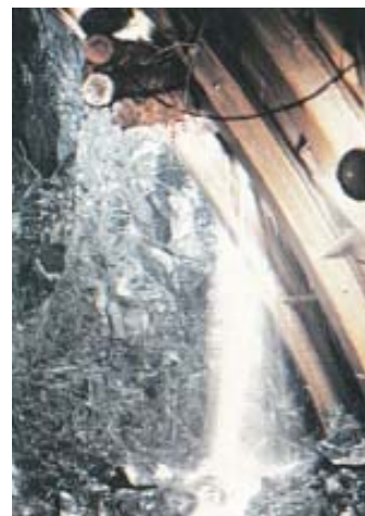
写真-2 湧水状況 1)
