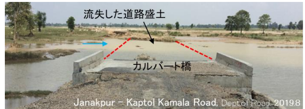
図-6 氾濫水が越流して流失した道路盛土 ネパール道路局
