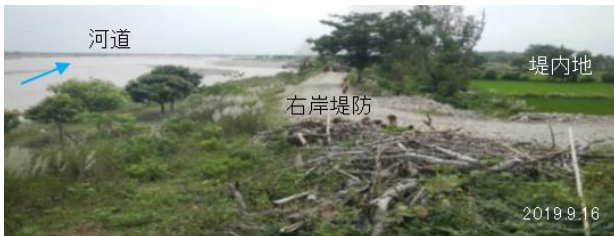
図-4 カマラ川では河床が堤内地盤高より高くなっている
