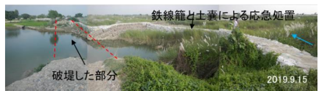
図-5 2019 年 7 月洪水で破堤したラル・バケヤ川左岸堤防
