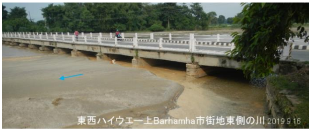
図-2 河床が上昇し橋脚フーチングが埋没、桁下高が低減した
