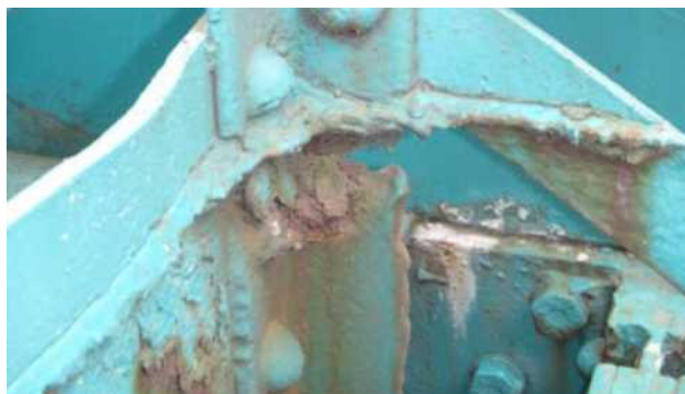
写真-3 格点内部の腐食
