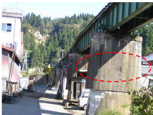
写真-1 無筋橋脚の打継目損傷 (新潟県中越地震) 2)
