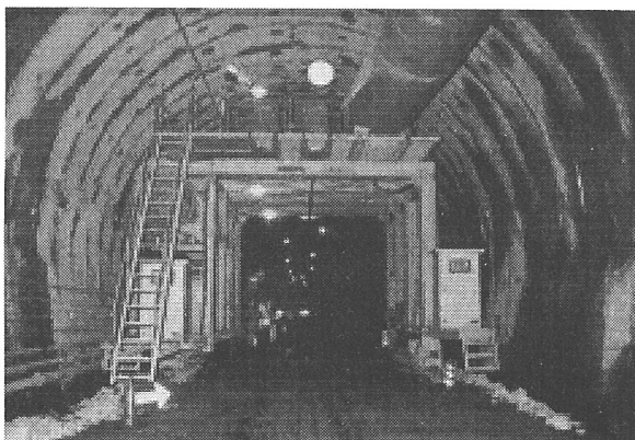
写真－１ 坑内換気架台
