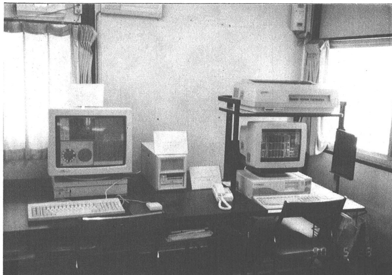
写真-1 中央制御室 (ワークステーションとパソコン)
