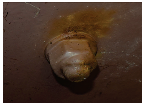
図-2 GFRP 歩道橋のステンレスボルトの腐食
