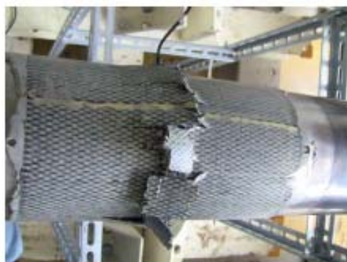
写真-1 圧壊・剥離の発生例
