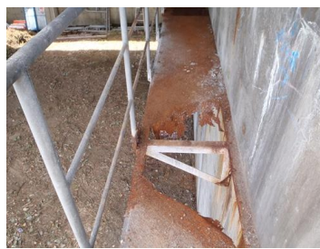
写真-2 鋼で製造された検査路の腐食状況 16)
