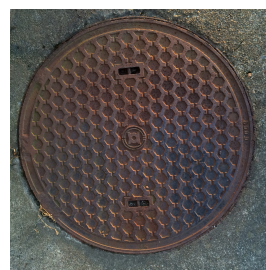
写真-1 鋼で製造されたマンホール蓋の腐食状況
