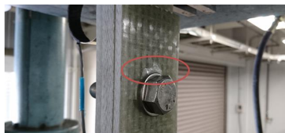
図-11 添接板における支圧破壊(J20)
