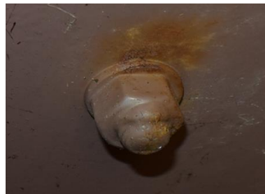
図-2 ステンレスボルトの腐食の例
