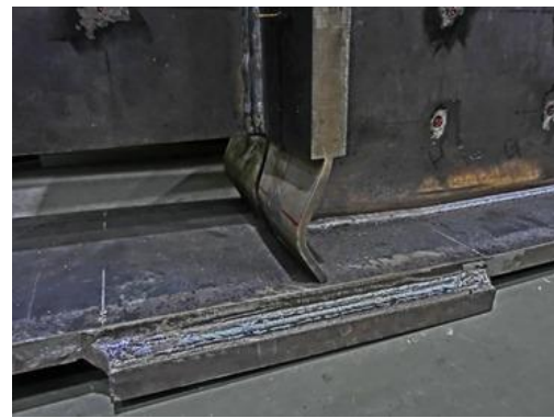
写真5 Case-2 の支点上補剛材の座屈
