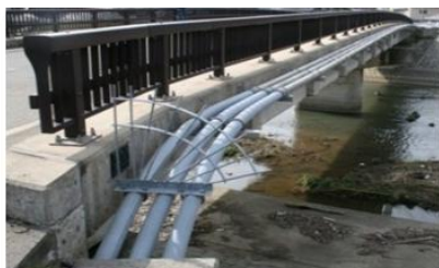
橋梁添架管路
