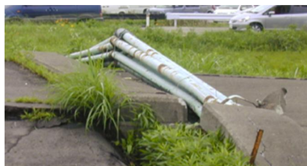
図-4 管橋の座屈例
