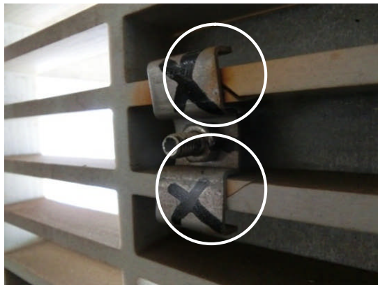
写真-14 押さえ金物直下のグレーチング部材の割れ
