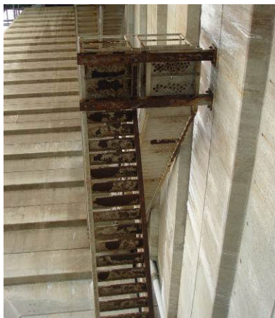
写真-1 激しく腐食した海上基礎の管理路階段 （下から）
