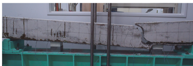
図-6 BFRPシート剥離の様子
