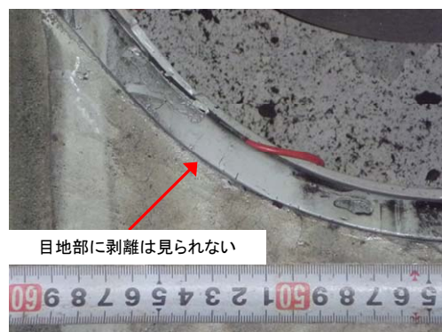
図-19 FRP の目地部の状況（ケース 4）
