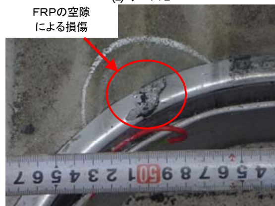
(2) ケース 3 図-17 FRP の変状
