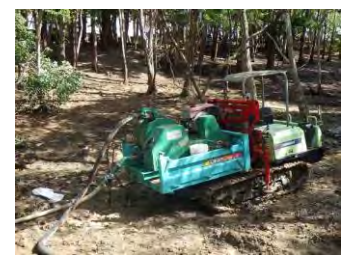
写真-7 中継ポンプ
