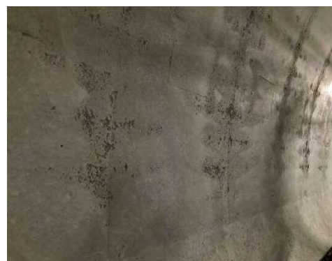
写真-1 剥離状況
