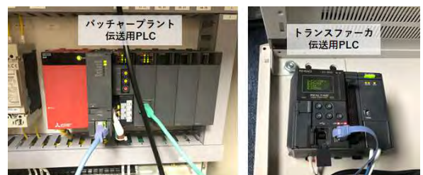
写真-4 バッチャープラントの通信機器
