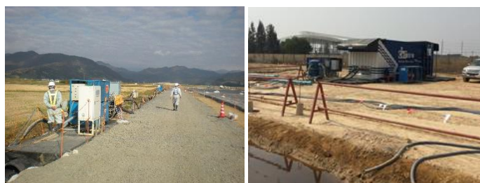
写真-4 真空設備の配置（左：日本、右：当地）
