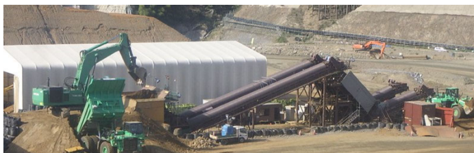
図-3 コア材混合設備の全景
