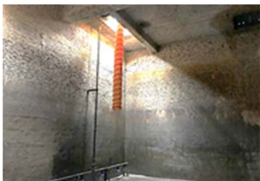
写真-1 補修前(全体)
