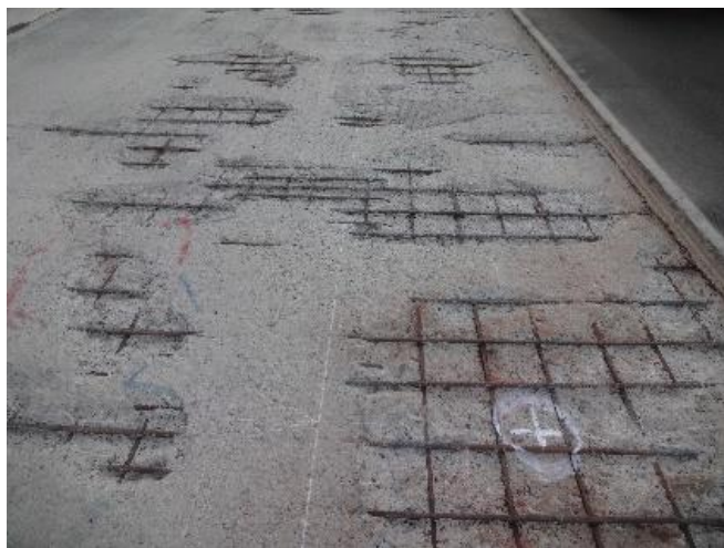
写真-1 床版上面の劣化状況
