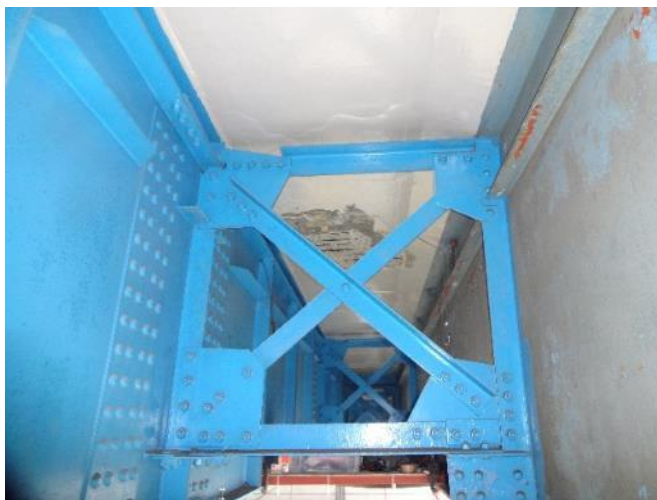
写真-4 床版下面劣化状況
