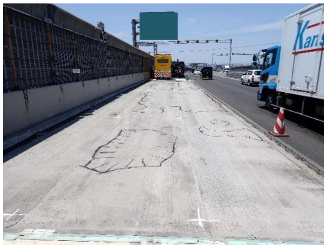
写真-3 床版上面劣化状況(マーキング部)
