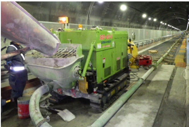
写真-10 自走可能型定置式ポンプ
