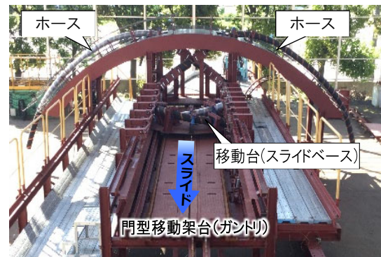
写真-5 打設システムの構造
