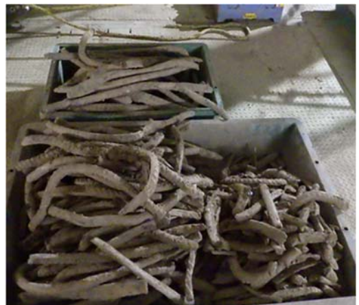
写真-8 氷川橋橋台区間の回収鉄筋片
