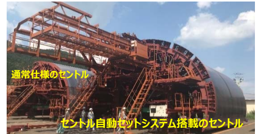
写真-1 使用したセントルの全景
