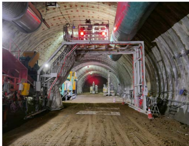
写真-4 赤色 LED 照明発報状況
