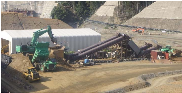
写真-2 コア材混合設備全景
