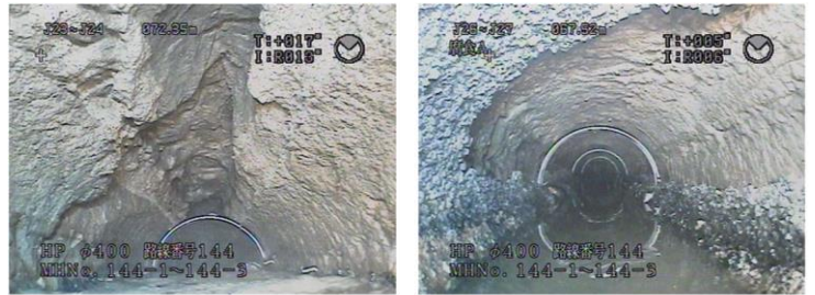
図8 既設管内の劣化状況
