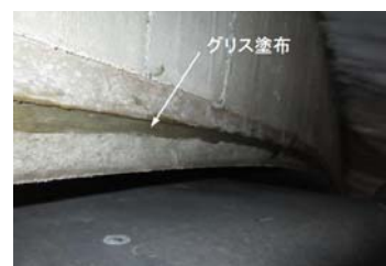
写真-6 付着力によるひび割れ対策
