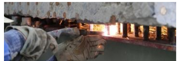
写真-6 ずれ止め(スタッド)の切断
