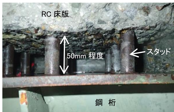
写真-1 鋼桁と床版の分離状況
